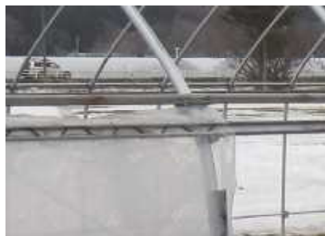
写真15 被覆を固定するスプリング
