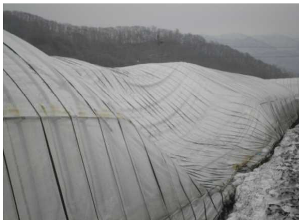
写真1 隣接ハウスからの落雪により半壊 (撮影：H30年3月14日)
