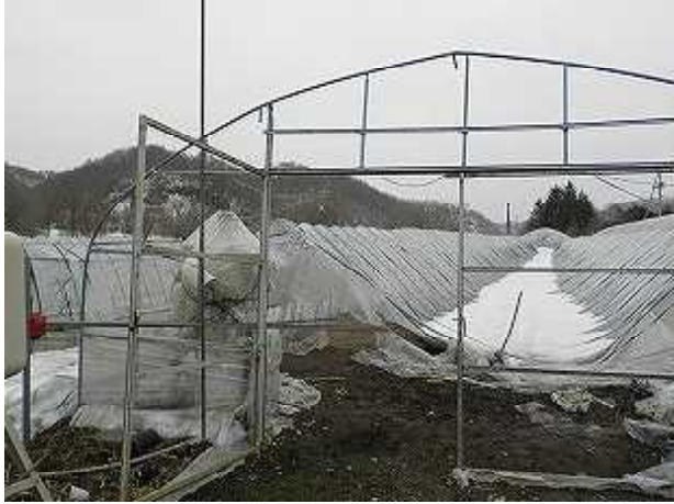
写真2 山側より倒壊が始まりビニールを 展張していたハウスは全棟倒壊と なった。
