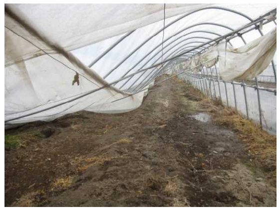
写真14：2月6日 静内川合 倒壊ハウス内部
