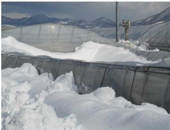
写真5：2月6日 静内東別 ハウス倒壊 外観
