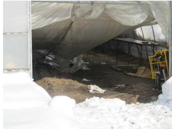
写真4：2月6日 新冠町明和 ハウス倒壊 内部
