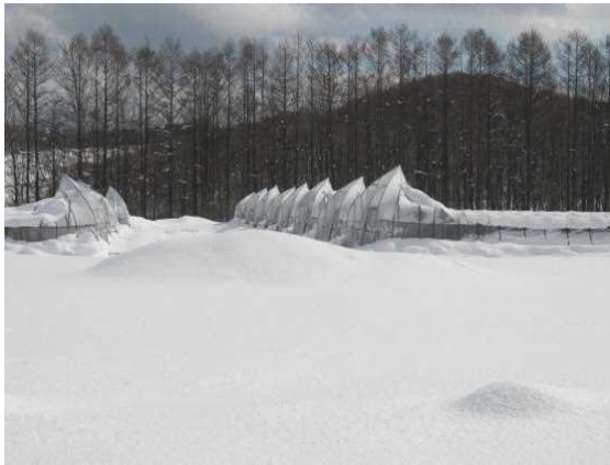
写真3：2月6日 新冠町明和 ハウス倒壊 外観
