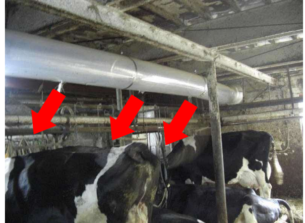
写真2 ダクトファンの稼働状況
