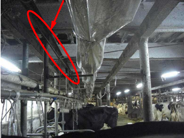
写真1 ダクトファンの設置位置
