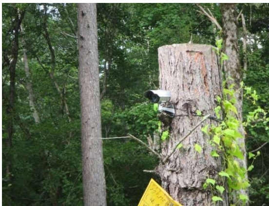
【監視カメラの設置状況】
