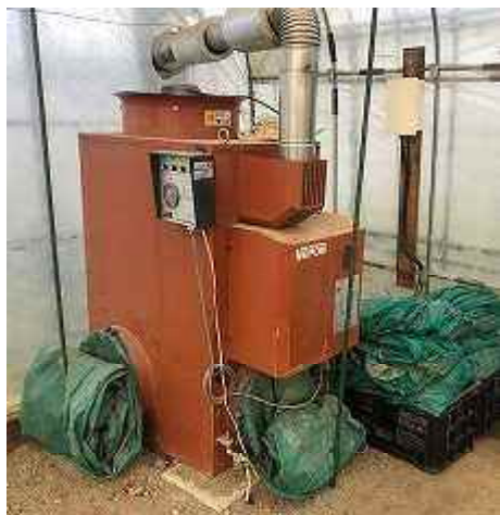
写真10 暖房を稼働させ ハウス内を加温
