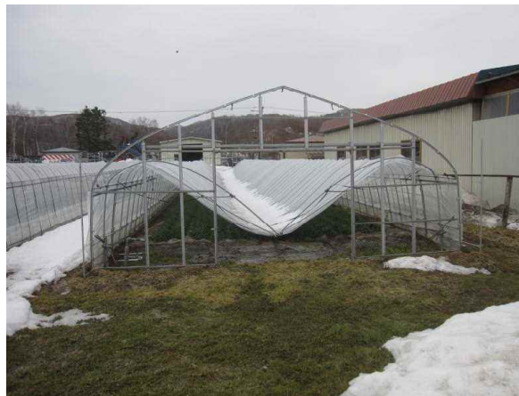
写真 1 屋根に雪が降り積もり倒壊した様子 (撮影 H30年3月14日)
