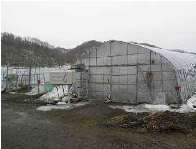
写真3 育苗棟は、他のハウスよりやや大きく、 除雪が間に合い、倒壊に至らなかった。
