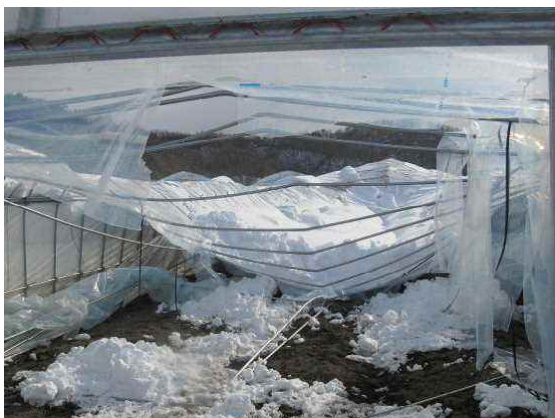
写真13：2月6日 静内田原 倒壊ハウス内部
