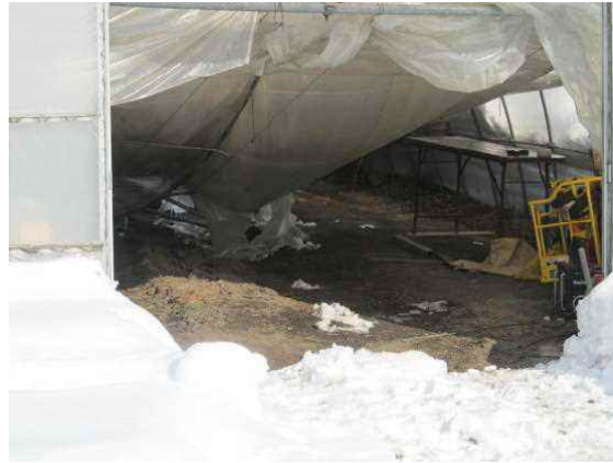
写真4：2月6日 新冠町明和 ハウス倒壊 内部
