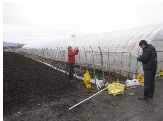
写真20：3月13日静内豊畑 倒壊したハウスの概要調査
