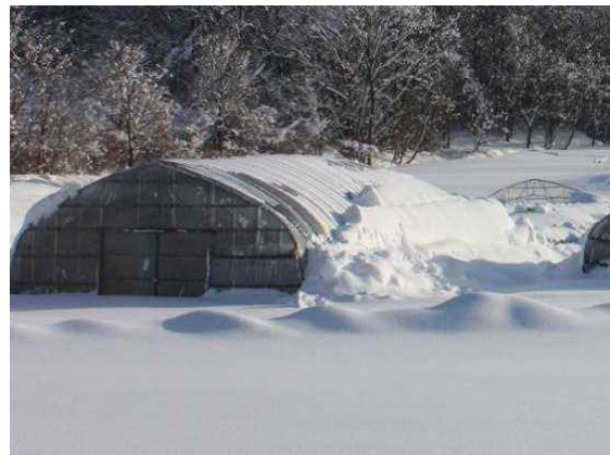
写真6：2月6日 静内東別 落雪部分と未落雪による倒壊
