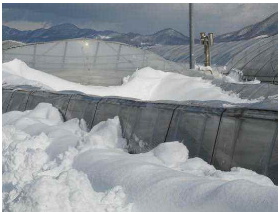
写真5：2月6日 静内東別 ハウス倒壊 外観
