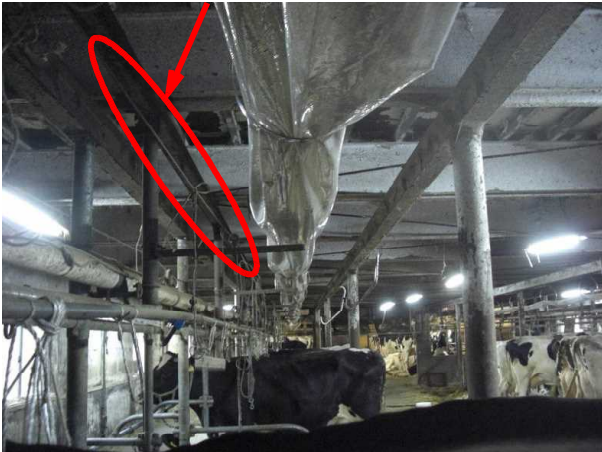
写真1 ダクトファンの設置位置
